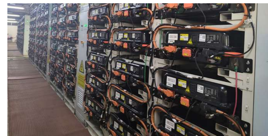
热轧锂电储能项目
