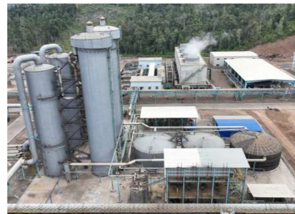
煤气净化脱硫化氢系统
