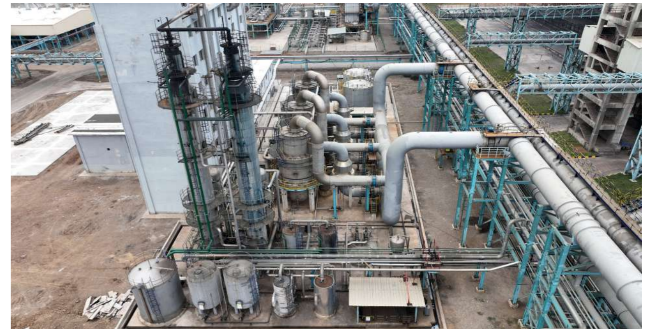
生产废水处理装置 -- 蒸氨系统
