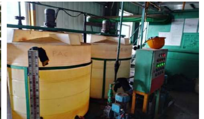
生活污水净化处理装置
