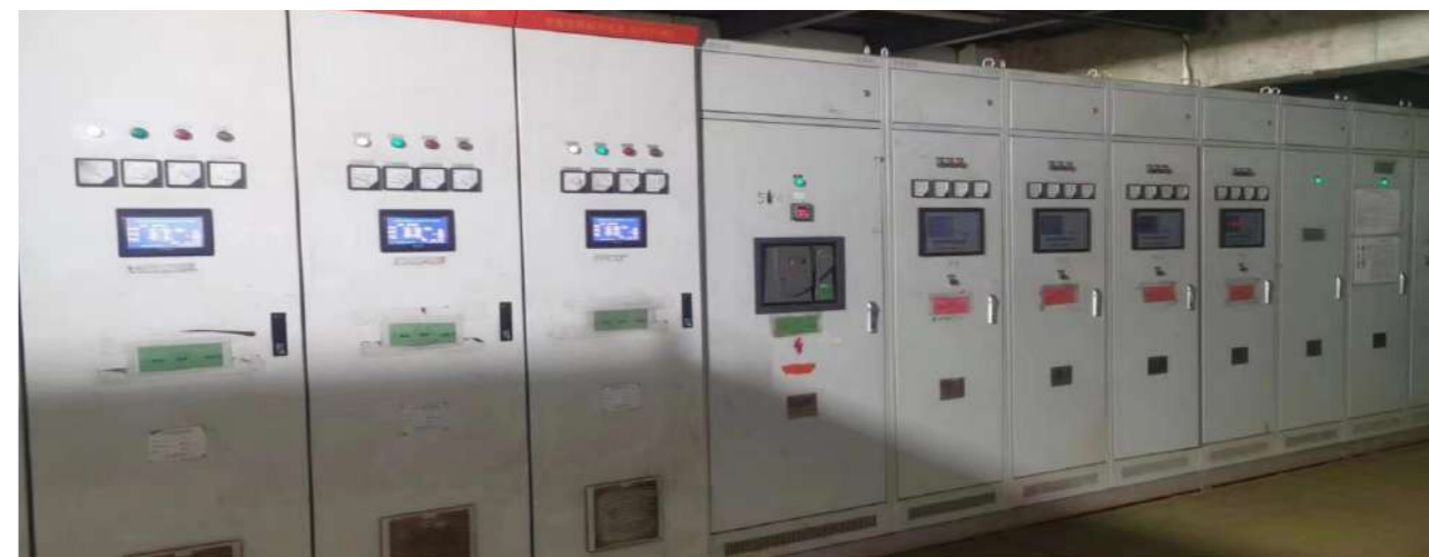
电除尘智能脉冲变频控制系统
