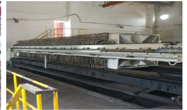
生产废水压滤处理回收利用
