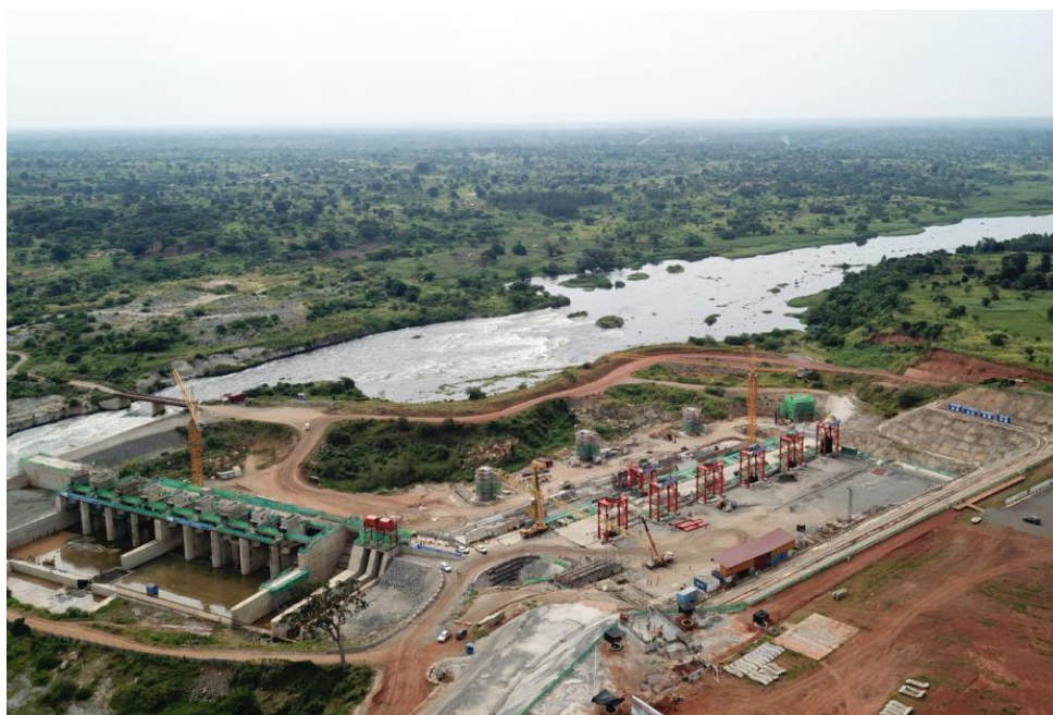
卡鲁玛水电站
